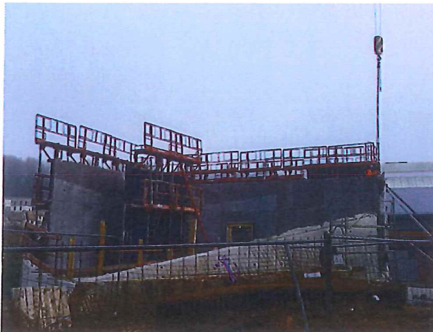
La construction du nouveau bâtiment d'accueil, qui abritera aussi une boutique, une cafétéria et des salles polyvalentes, est bien engagée.
