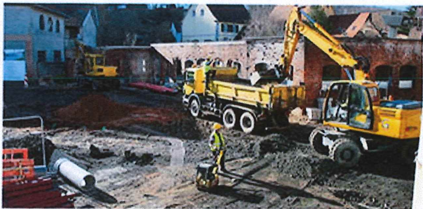
L'ancienne moulotheque doit aussi être démolie pour construire le nouvel accueil. Photo RI
